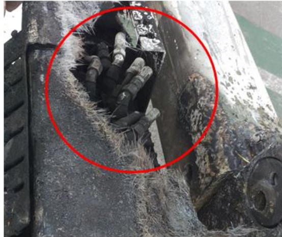
Figura 6, Falla en la consola de control superior
