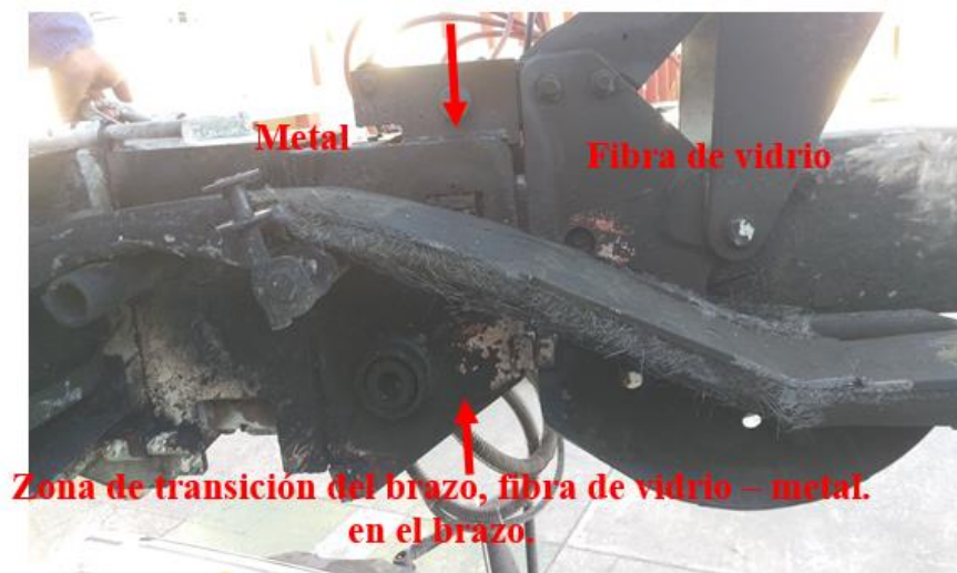
Figura 5, Zona de transición metal fibra de vidrio dañada
