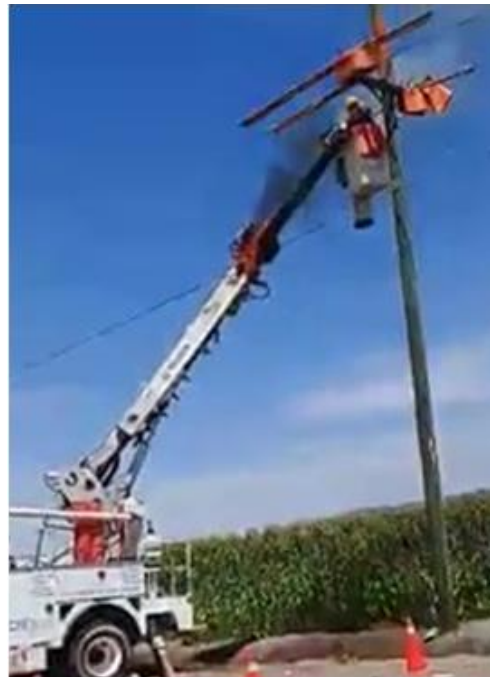
Figura 1. Presencia de fuego en zona de transición metal con la fibra de vidrio del brazo aislado.
